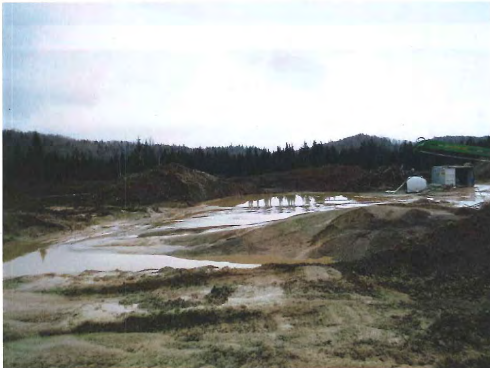
Image 23: Réservoir d'eau servant au lavage des agrégats et bassin de rétentions des eaux de lavage
